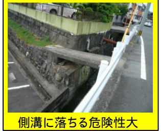
側溝に落ちる危険性大
